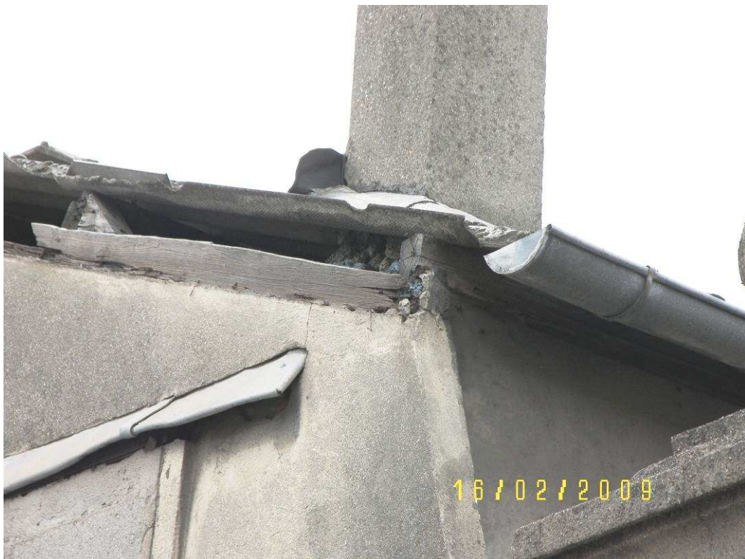
Ouverture constatée dans le comble bâtiment C2 coté rue de Mitry
